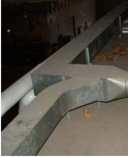
Toilet Exhaust Fan EF-4
