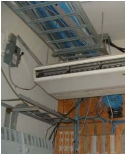
INTERIOR AC-1 FAN
