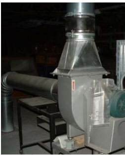
WELDING EXHAUST FAN
