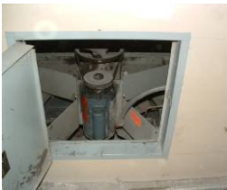
AHU-1 Relief Fan RF-2.
